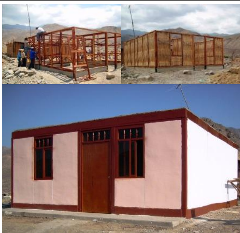
Casa modelo contruida por CIDAP usando la técnica de quincha mejorada en diferentes etapas de construcción. Federación Internacional / P. Cavero
